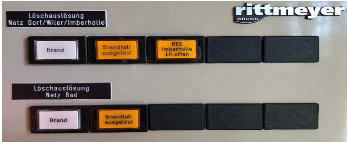
Bild: Leitzentrale beim Feuerwehrmagazin
